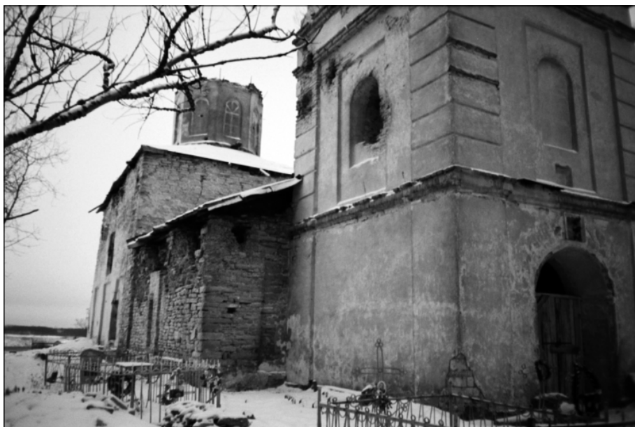
Вид с северо-запада. На стене колокольни видны пробоины от обстрела 1944 г. Фото 2001 г.
